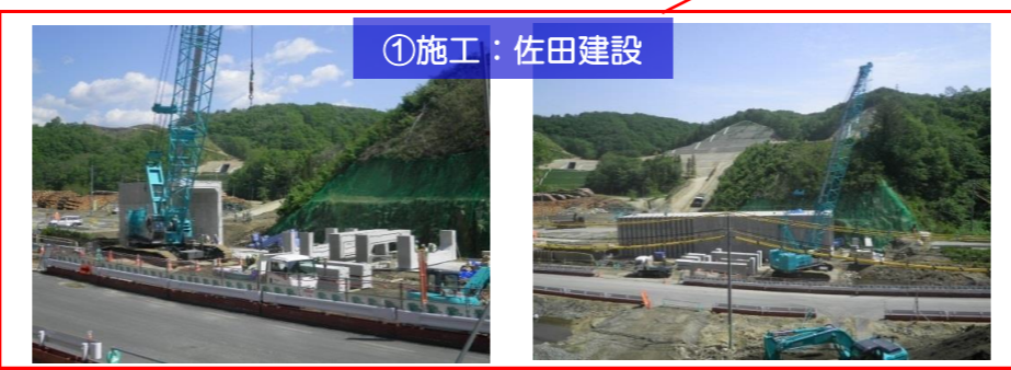
大型クレーン(120t吊り)を使用したボックスカルバートの設置を進めております。5月末にて市道部が完了し、6月中旬からは水路部を設置します。
